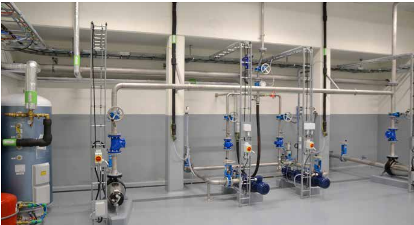
Et moderne lyst og luktfritt rom for pumpene til sand- og fettfangerne. Duken i veggen fører fuktighet og drypp fra tak og vegger, ned i egnet drenering. På denne måten får man fullstendig kontroll på truende fuktighet. Foto: Kjell M. Jacobsen
