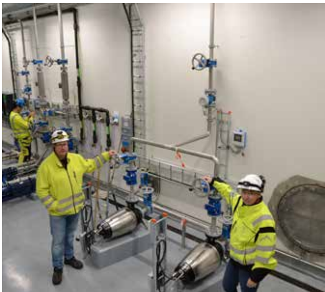
Prosjektlederene i pumperommet for slagbehandling fra venstre: Robert Flister avd.ing. VA og Grete Nesheim prosjektleder – Prosjektavdelingen. Foto: Kjell M. Jacobsen
