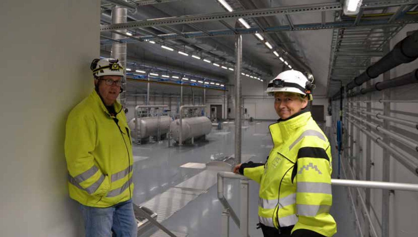
Prosesshallen er de meget stolt av. Den er på topp miljømessig med det siste av teknisk utstyr installert klart for prøvedrift i disse dager. Fra venstre Robert Flister (avd.ing. VA) og Grete Nesheim (prosjektleder). Foto Kjell M. Jacobsen.
