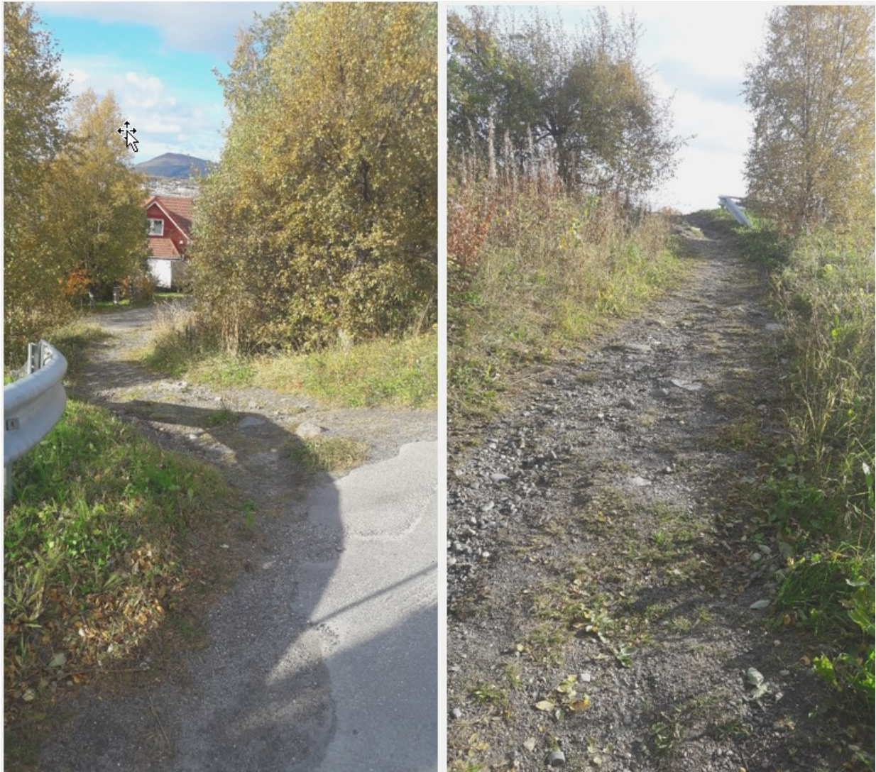
Figur 2. Vei fra fotgjengerfelt ved E6 og ned til Nerigardsveien. Underlaget er ujevnt og må utbedres/bredden utvides.
