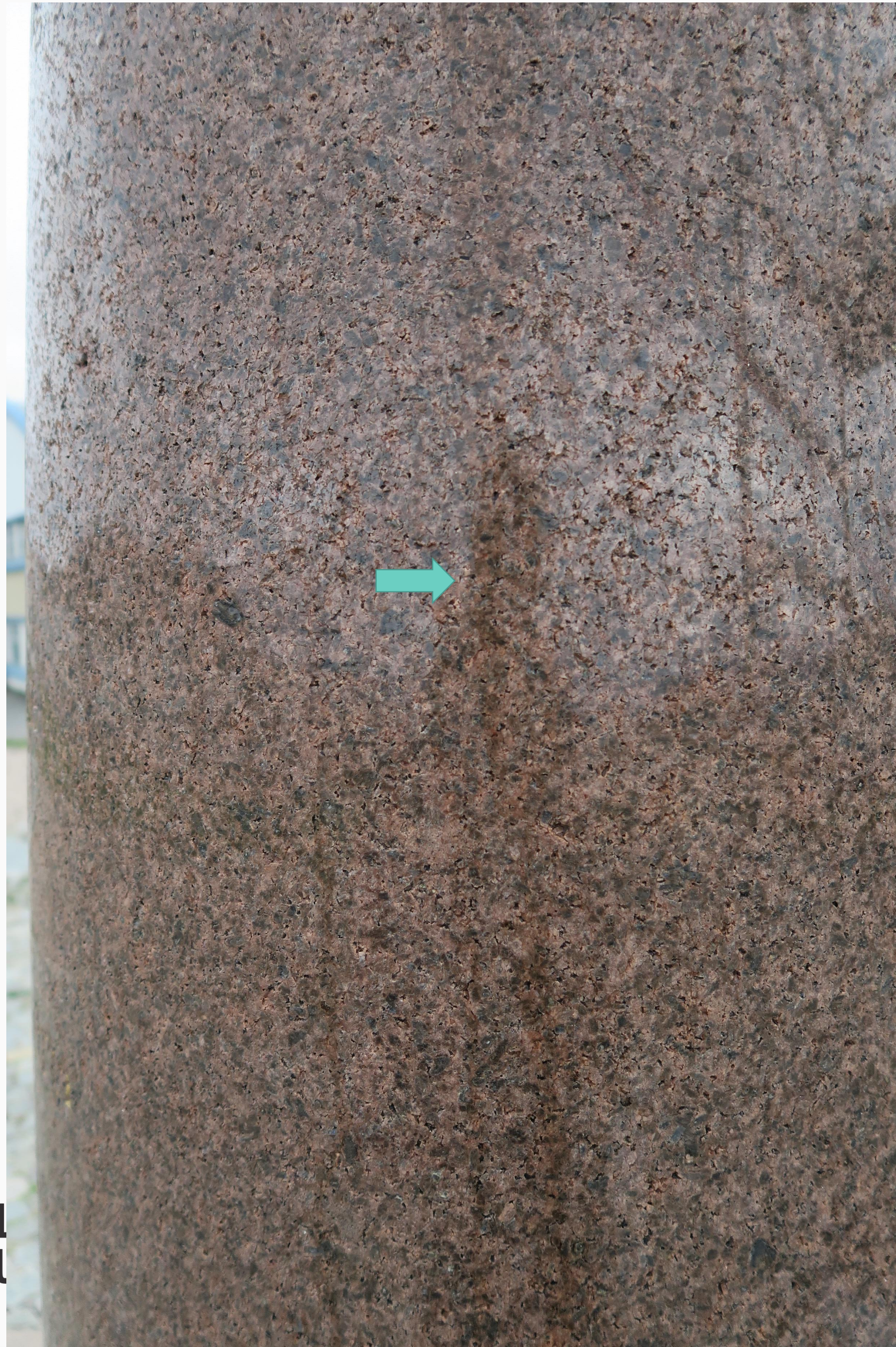
Tilstand- slitt av vær og tegn på tagging
