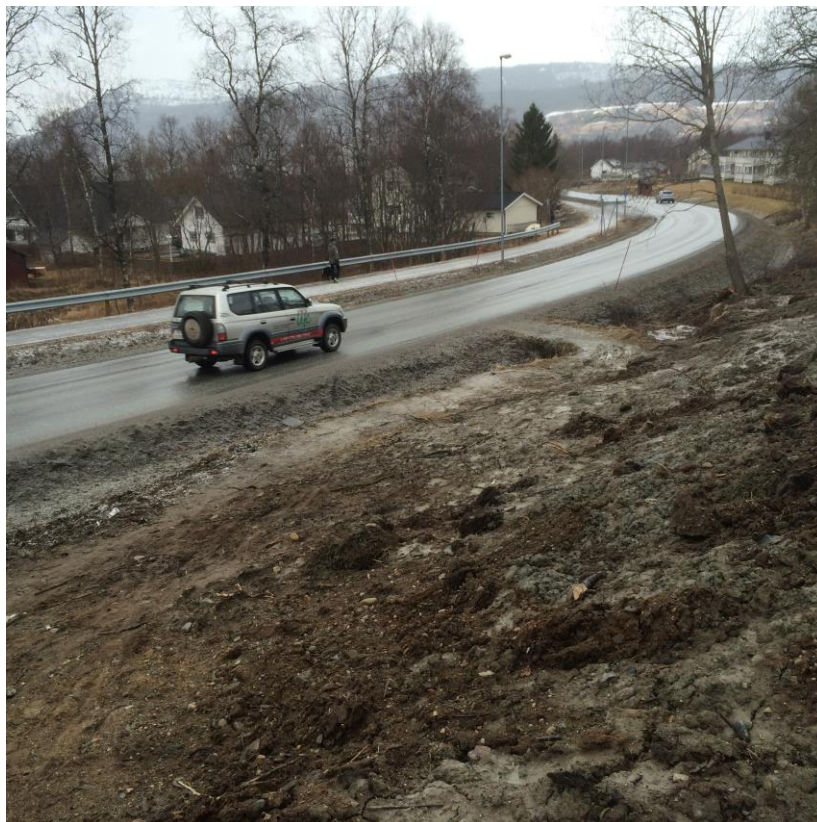
Figur 44. RV80. Kryssingspunkt ved Marbakken. Se også fig 40. Her bør fyllingen i grøften fjernes. Foto 20.04.15. M. Selnes
