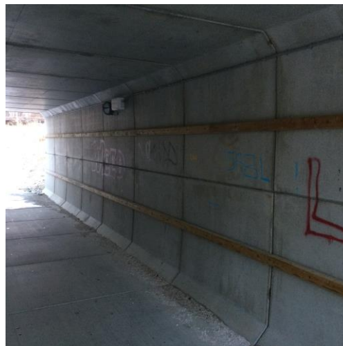
Figur 23. Lyspunktet i kulverten under jernbanen. Foto M Selnes
