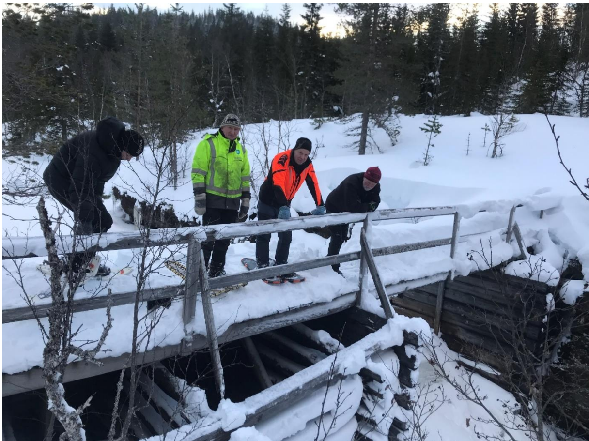
Restaureringsbehov tømmerdemning Årengtjønnå, befaring Mars 2020
