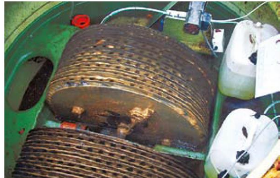
Bilde av biorotoren under.
