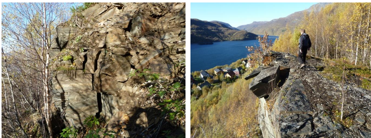
Bilde 6.2-2 viser eksempler på ustabile parti fra brattskrenten ovenfor husene.
